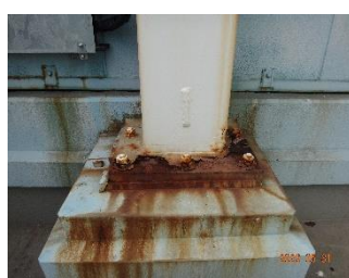
鉄骨の錆の状況
