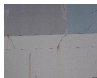
外壁クラック状況
