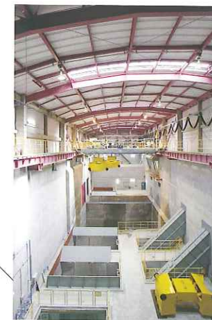
1 びん・缶ピット びん・缶を一時貯留します。びん・缶は資源化ごみクレーンでホッパに投入されます。
