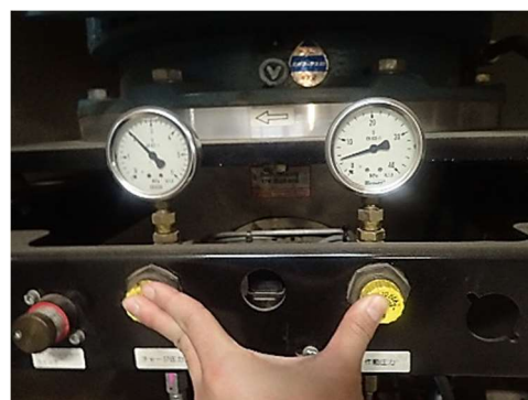
写真 6 チャージ圧力計と作動圧力
