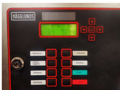
写真 5 スパイダー液晶表示盤
