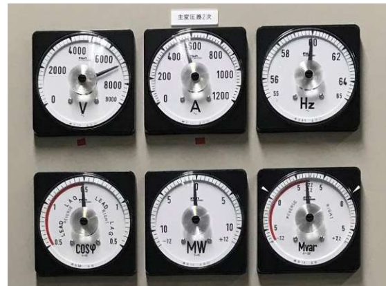
写真1 故障時の状況
