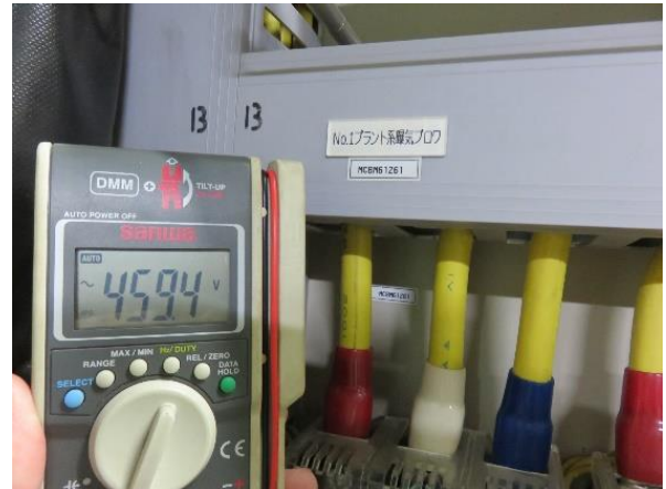
写真-2 ブロワ電圧
